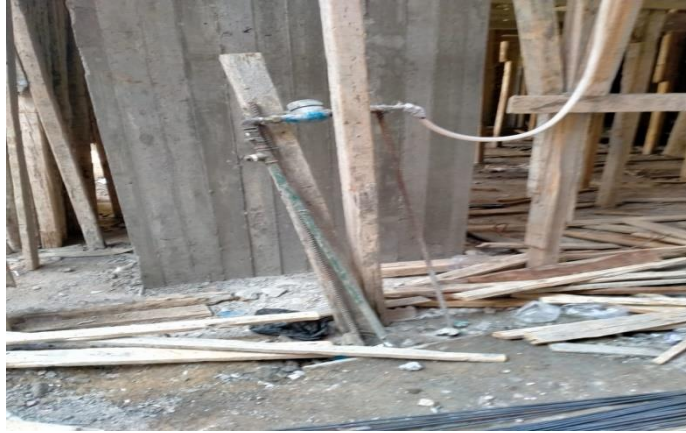
(صوره توضيحيه لمخالفة هدم وبناء)
